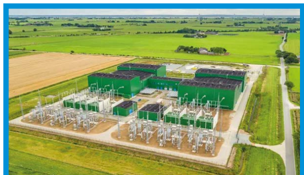
Bild 3: Nordlink Onshore Konverterstation
