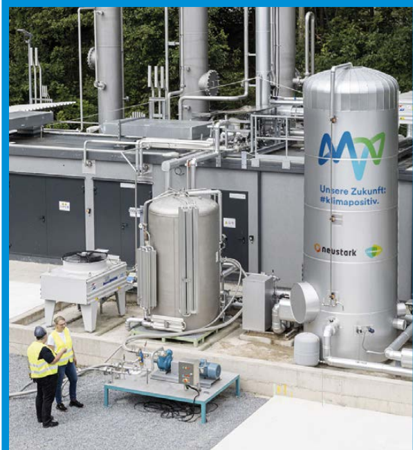
In Dresden betreibt MVV mit einer Bioabfallvergärungsanlage bereits die erste konzerninterne #klimapositive Anlage. Mit einer Pilotanlage in Mannheim testet MVV außerdem derzeit die Abscheidung, Verflüssigung und die Verladung von CO 2 im vollständigen Prozess-Setup
