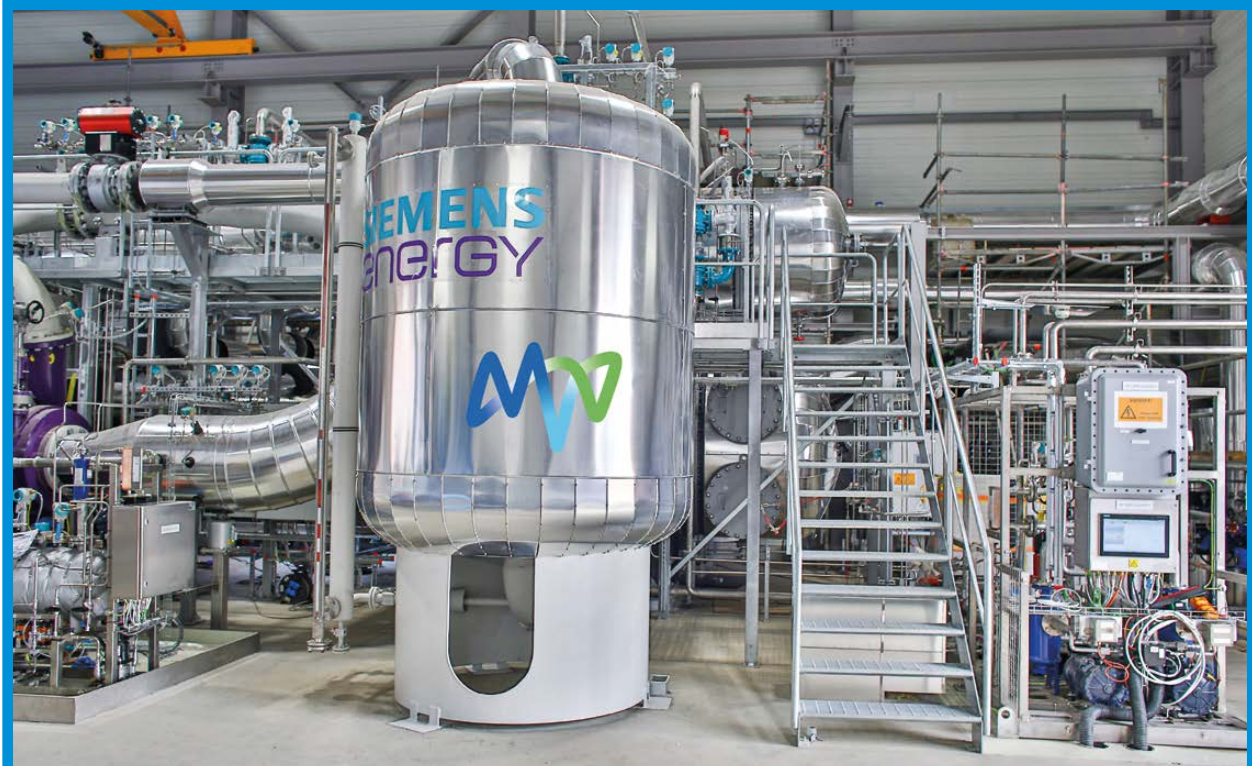
Die MVV Flusswärmepumpe ist die aktuell größte, in ein Fernwärmesystem eingebundene Flusswärmepumpe Deutschlands. Sie versorgt rechnerisch 3.500 Haushalte in Mannheim und der Region.
